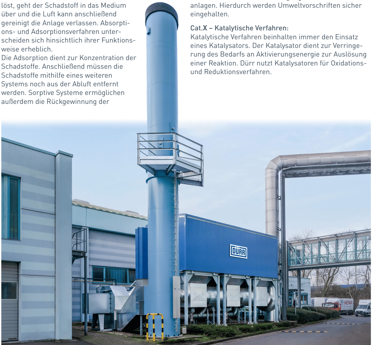
Abb. 3: RTO-Technologie zur effizienten Abluftreinigung
